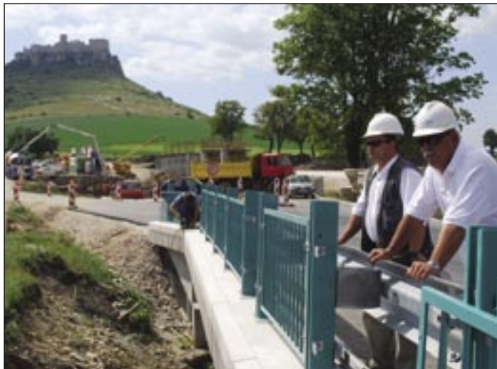
Možno pod najkrajšími slovenskými hradbami: stavbyvedúci Štefan Molčan a Albert Timko na moste 215, ktorí ľudia zo závodu 06 postavili za dva a pol mesiaca.
